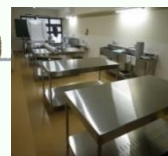
綺麗で清潔な厨房の整備
