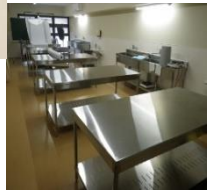
排水性を有した厨房
