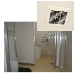
定員に応じた規模、換気設備を有したトイレ
